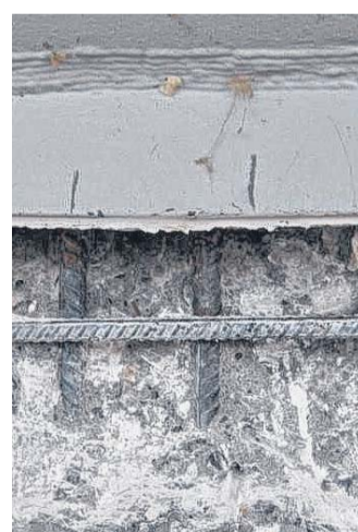
Der Stahl unter dem Beton ist bereits zu sehen. FOTO: RAUCH
